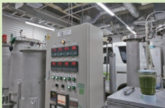
バイオガス発電システム
